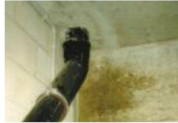
Aussenwand mit Feuchtigkeit und Schimmel
