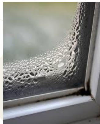
Fenster mit Feuchtigkeit und leichtem Schimmel
