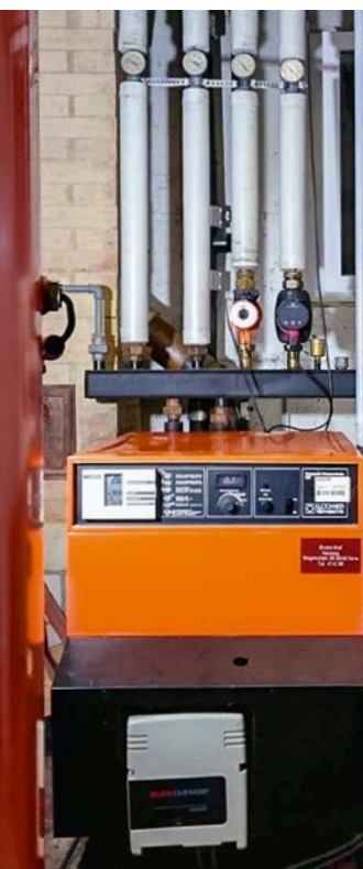
Der Ersatz des Wärmeerzeugers ist rechtzeitig zu planen.
